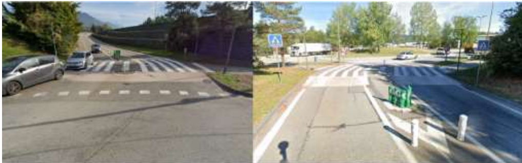
Réalisation d'un îlot refuge + plateau surélevé + marquage type résine colorée à Annecy
